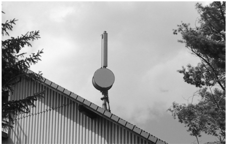
Abb. 1.18: Eine typische Antenne einer GSM Basisstation. Die zusätzliche optionale Richtfunkantenne (runde Antenne unten) verbindet die Basisstation mit dem GSM Netzwerk.
